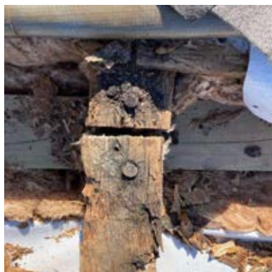
Obr. 1 Ukážka hnilobných a korozívnych procesov v nesprávnej konštrukcii strechy
