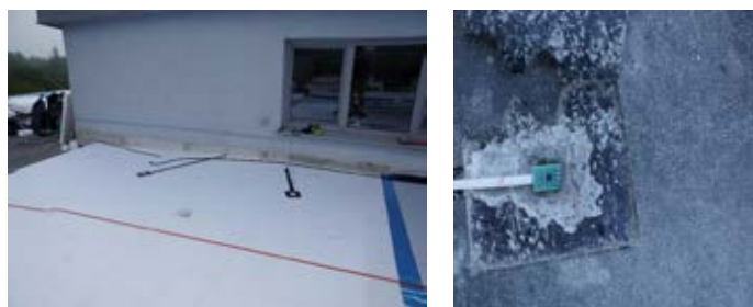
Obr. 4. Montáž kombinovaných snímačov Sensirion SHT25 počas obnovy strešného pláštá na dve miesta. Nad pravým meracím miestom je v súčasnosti zhotovená vegetačná strecha.
