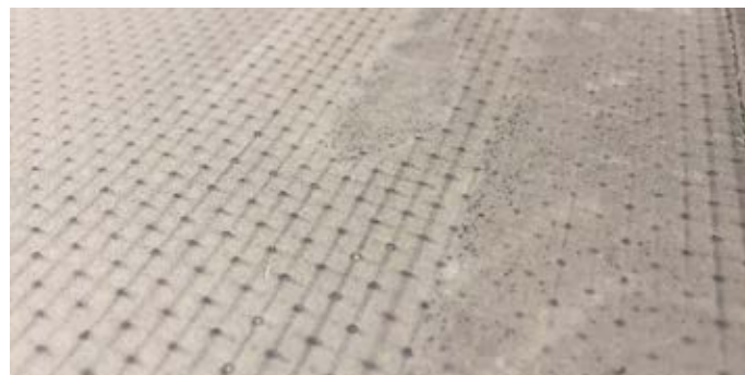
Obr. 3 UV degradovaná mPVC povlaková krytina v štádiu obnaženia výstužnej vložky (foto: M. Kováč)
