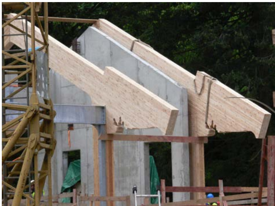
Nosná konstrukce pro těžkou střechu je opravdu masivní (stavební povolení nesmělo být vydáno, dokud nebyly doloženy statické posudky od minimálně dvou nezávislých institucí)
